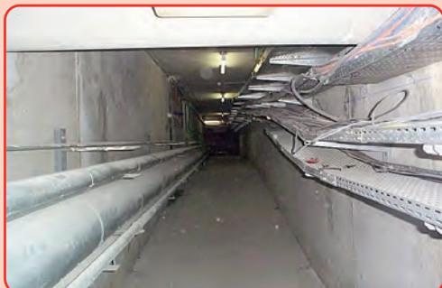
Galerie de câble
